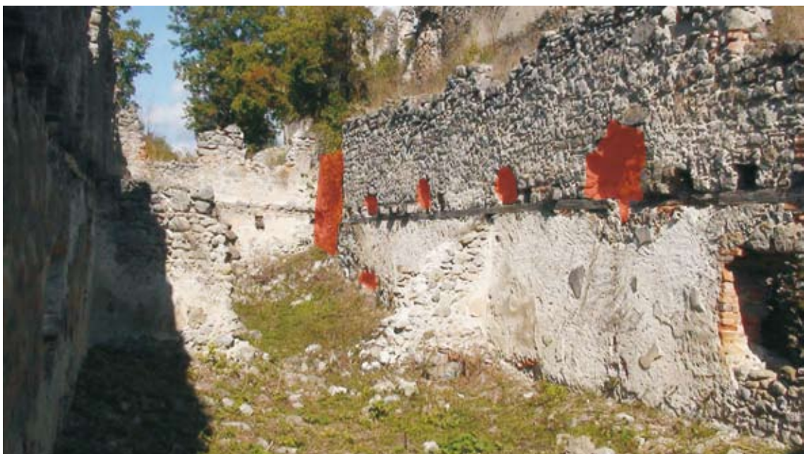
Jeden z príkladov rozsahu zamýšľaných opráv - domurovanie kaverny vzniknutej rozpadom trámovej kapsy, oslabené zaklenutie okenného otvoru, doplnenie výpadkov muriva
