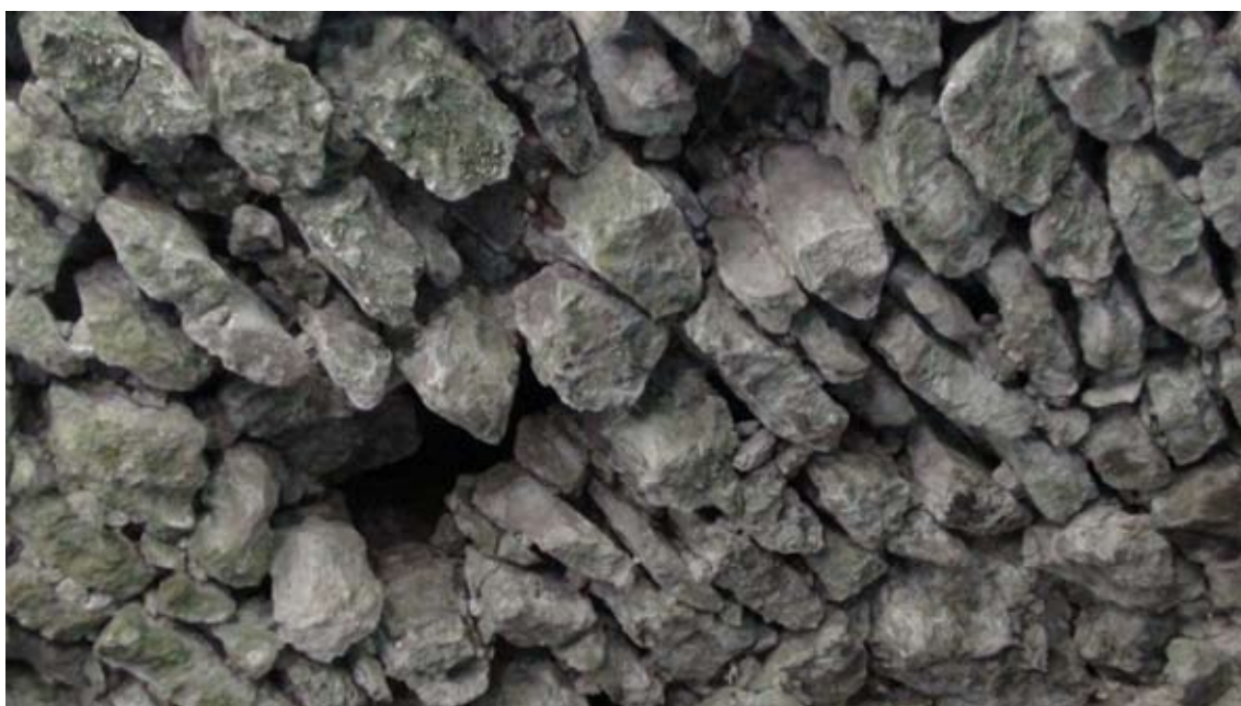
Detailný záber na poškodenie klenby pivnice, miestami už vypadávajú kamene
