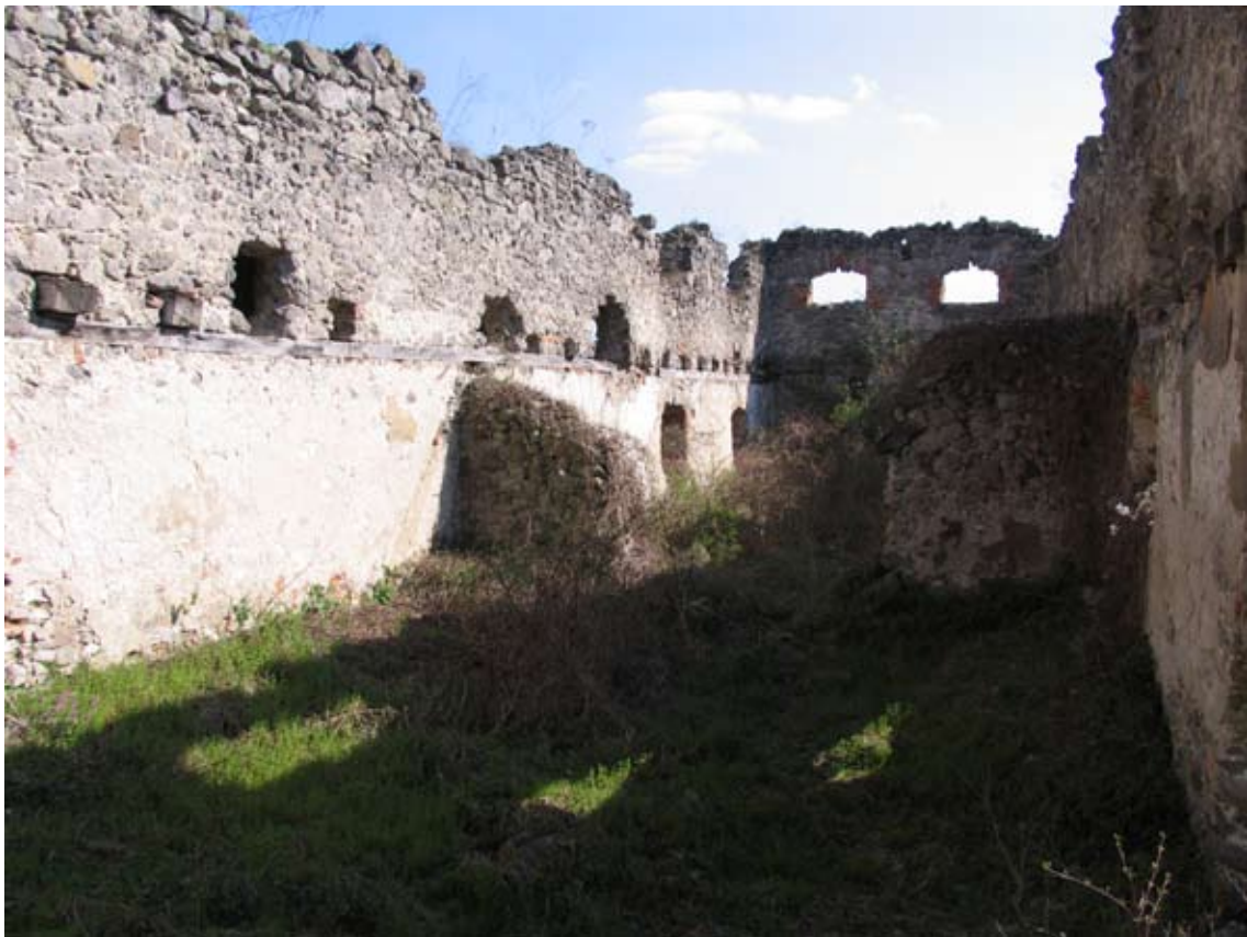
Interiér sýpky pri pohľade od vstupných dverí. Vľavo na stene pri interiérovej priečke vidno odtlačok pôvodného schodiska na poschodie. Postupným rozpadom otvorov pre stropnice dochádza ku vzniku kavern, ktoré ohrozujú stabilitu muriva
